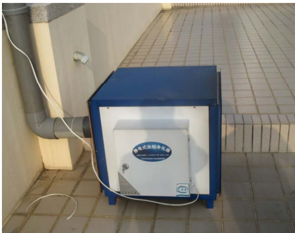
琛霸創意燒烤/靜電機設備
