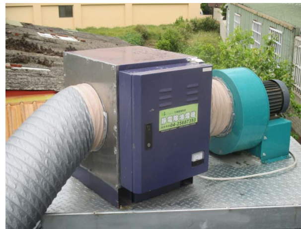
村香牛排館/靜電機設備
