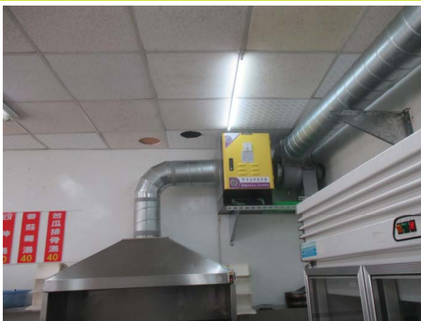
迪化街紅麵線小吃店/靜電機設備
