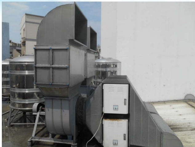
湘楠無煙燒肉/靜電機、活性炭設備
