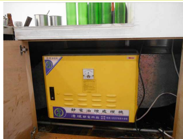
大埔鐵板燒苑裡店/靜電機設備
