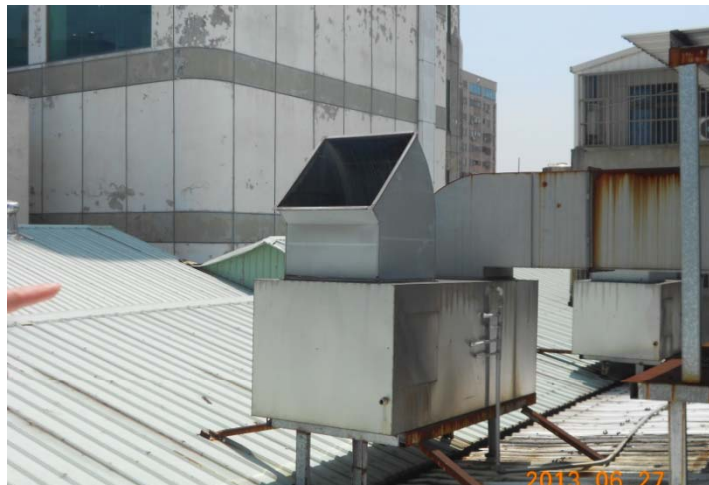
七木田燒烤店/水洗機設備
